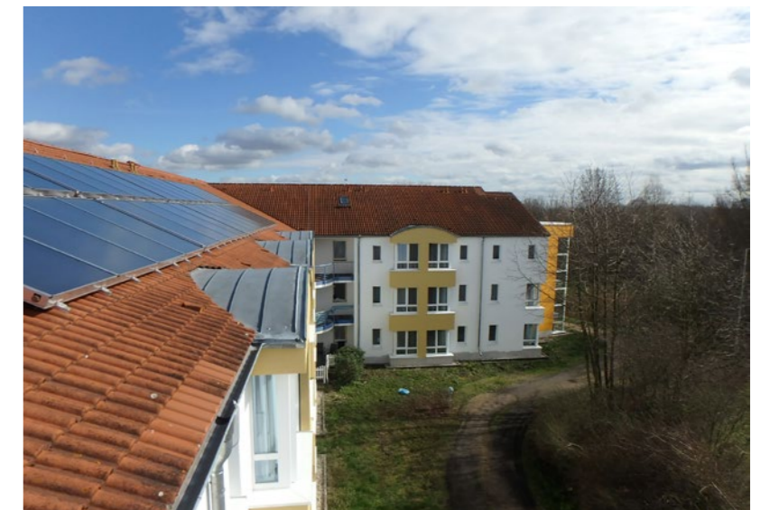
Die Solarthermieanlage auf dem Dach
